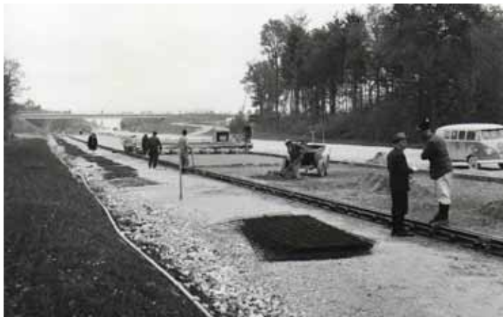
Les ingénieurs étaient nombreux pour diriger et planifier la construction de l'A1. Ici, des treillis sont déposés pour l'armature de la dalle. SERVICE DES ROUTES
